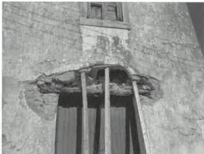
Aspetto da verga da porta em situação de pré-colapso
